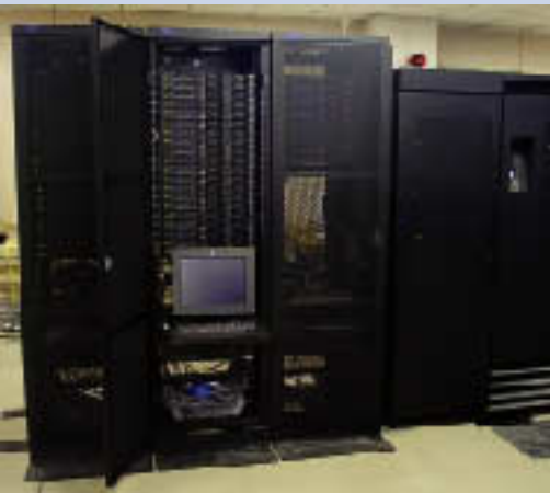
ホスティングサーバ(ホスティングサーバ活用基礎編)
